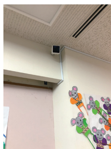
施設共有スペース設置の「みまもり CUBE」
